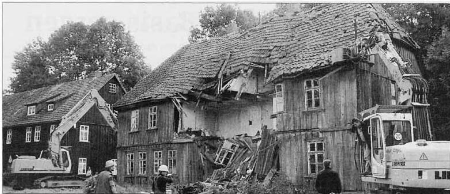
Mit zwei großen Abbruchbaggern wurde am Mittwoch das über 270 Jahre alte Fachwerkhaus zum Einsturz gebracht.
